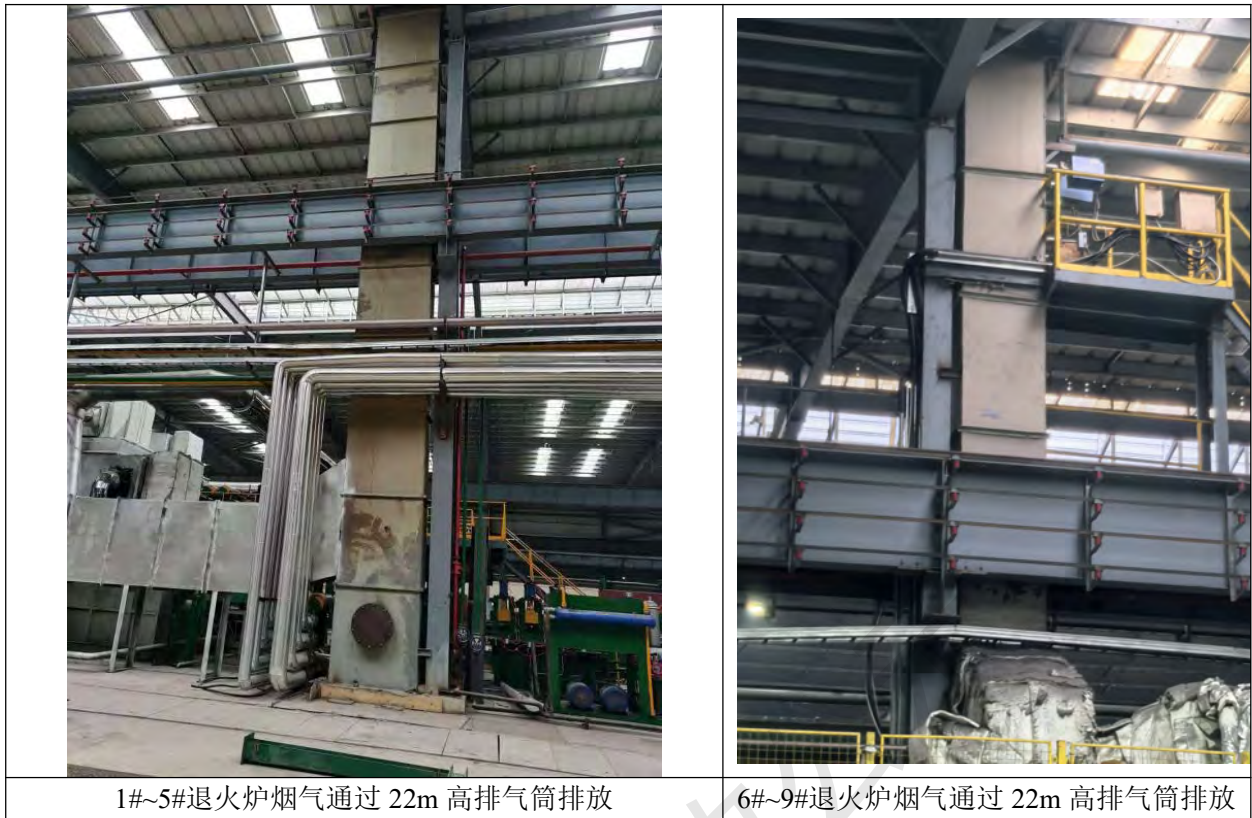
图 4.1-7 退火炉废气处理措施
