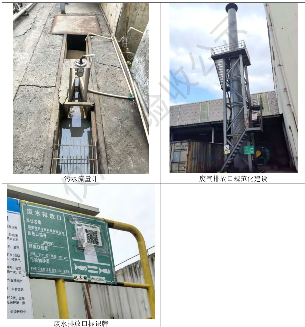
图 4.6-6 废水及废气排放口规范化建设
