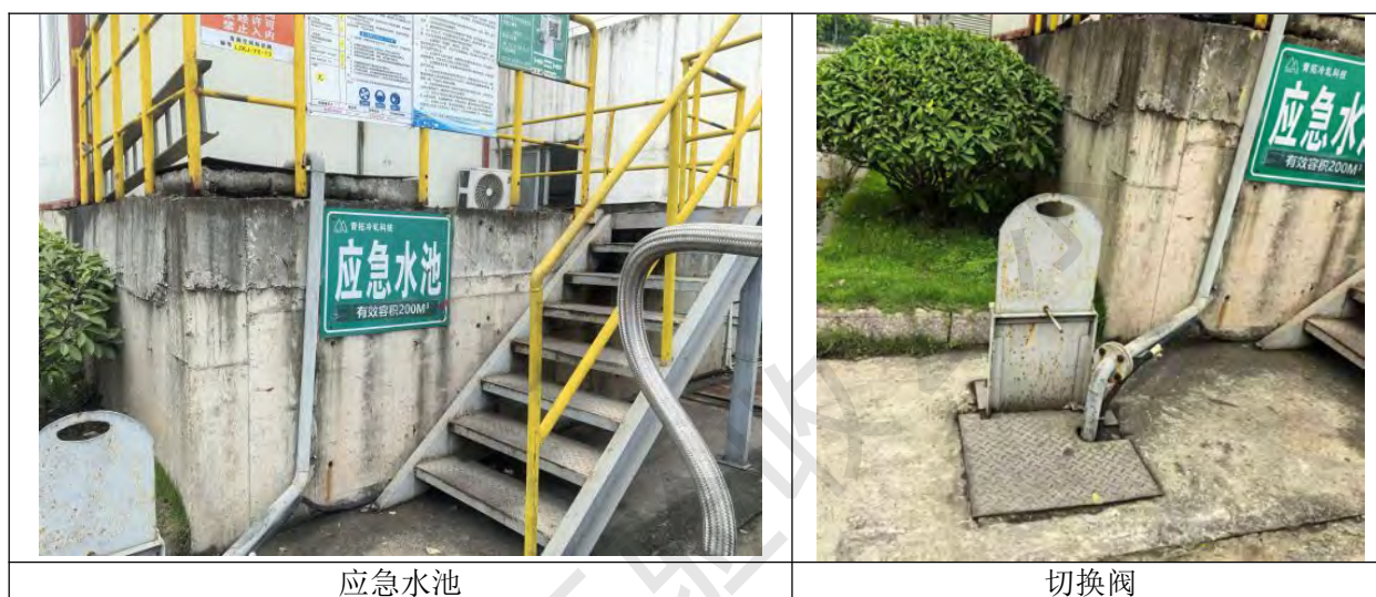
图 4.6-1 事故应急池及切换阀
