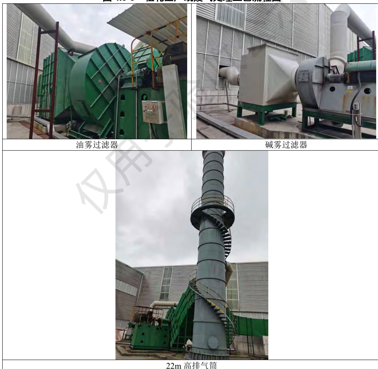
图 4.1-2 粗轧生产线废气处理设施
