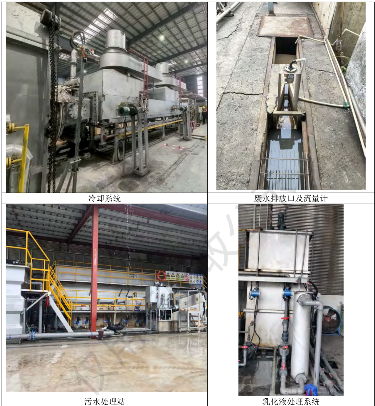
图 4.2-3 废水处理设施
